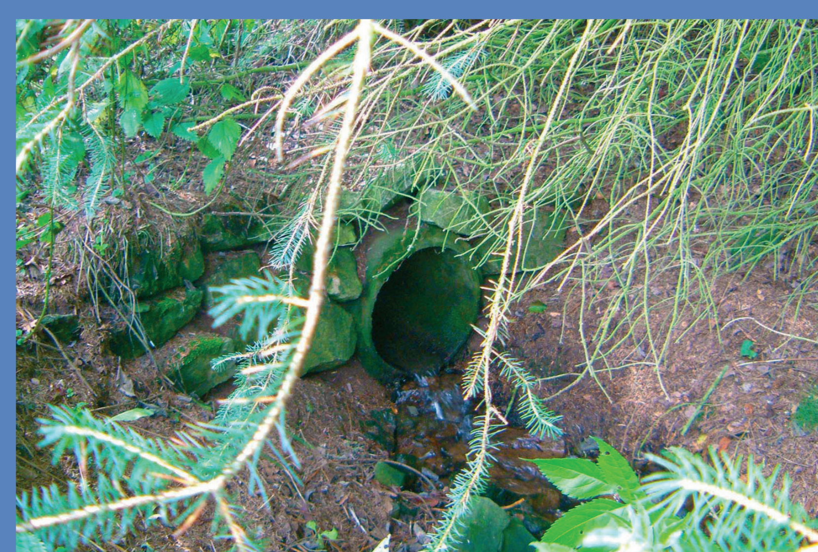
Verrohrung als Wanderbarriere, erhöhte Fließgeschwindigkeit durch engen Querschnitt und glatte Sohle.
